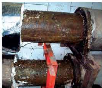
Kondisi pipa yang mengalami korosi.
