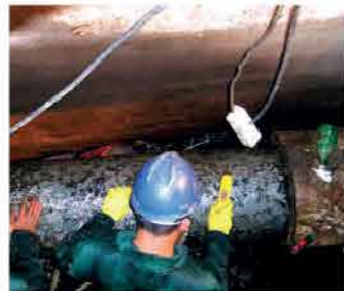
Persiapan permukaan dengan waterblasting dan grinding untuk mencapai 1/16" dibutuhkan amplitudo yang minimum.
